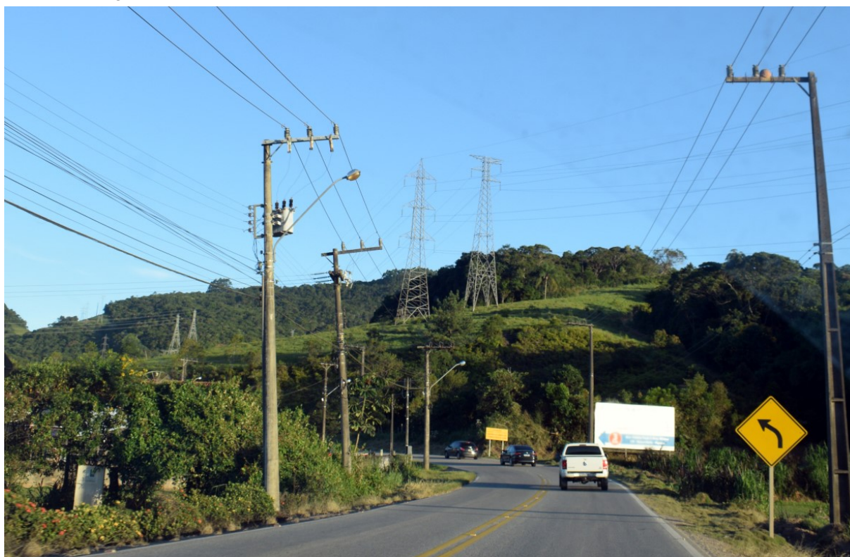
Figura 422. Linha de Transmissão e infraestruturas elétricas na SC-407
